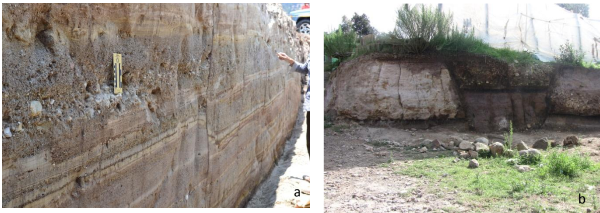
Figura 6.11. a) Desplazamiento de estratos de la trinchera SPA1 b) Desplazamiento de estratos en la trinchera SPA3. ESI 2007 IX-X.
