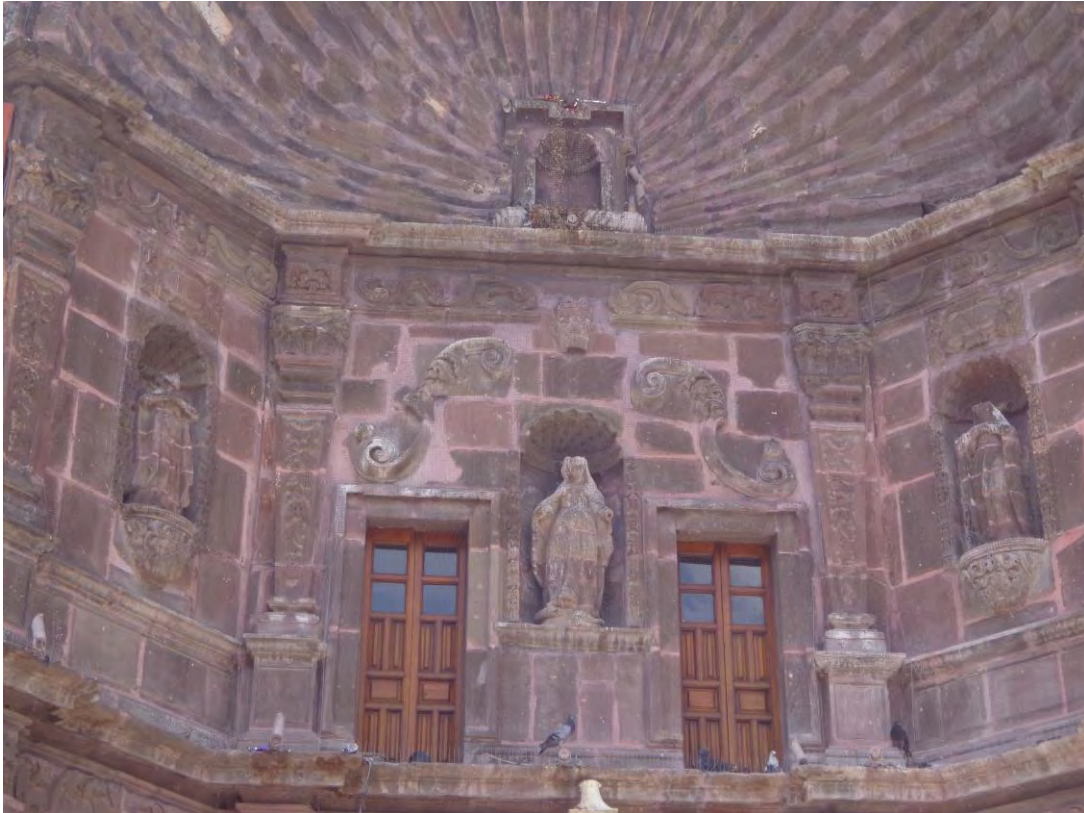
Fig. 37 Detalle de la fachada del Templo de Nuestra Señora de la Salud. Se pueden observar algunas figuras de santos que no tienen cabeza o están despostillados; su estado se encuentra deteriorado ya que no ha tenido intervenciones de restauración en la última década. Foto de Ruth Olvera, 2016.
