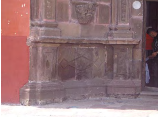
Fig. 39 Detalle de la fachada del Templo de Nuestra Señora de la Salud. Las bases de las columnas de la fachada se encuentran en un estado de deterioro por humedad, hace falta restauración urgente. Foto de Ruth Olvera, 2016.
