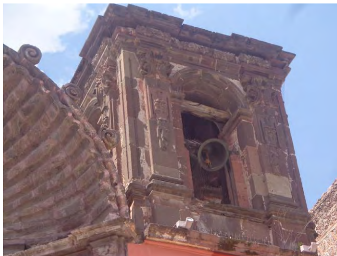
Fig. 38 Detalle de la fachada del Templo de Nuestra Señora de la Salud. Falta terminar la torre del campanario; su estado actual se encuentra deteriorado ya que no ha tenido intervenciones de restauración en la última década. Foto de Ruth Olvera, 2016.
