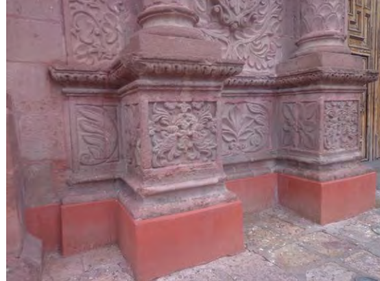
Fig. 40 Detalle de la fachada del Templo de Oratorio de San Felipe Neri. Observamos que las bases de las columnas de la fachada se encuentran en perfectas condiciones pues hubo una intervención en este templo en el periodo de restauración de toda la ciudad en 2009, tanto la fachada como muchas de las figuras de santos se encuentra en buen estado. Lo que nos indica que algún cantero participó. Foto de Ruth Olvera, 2016.
