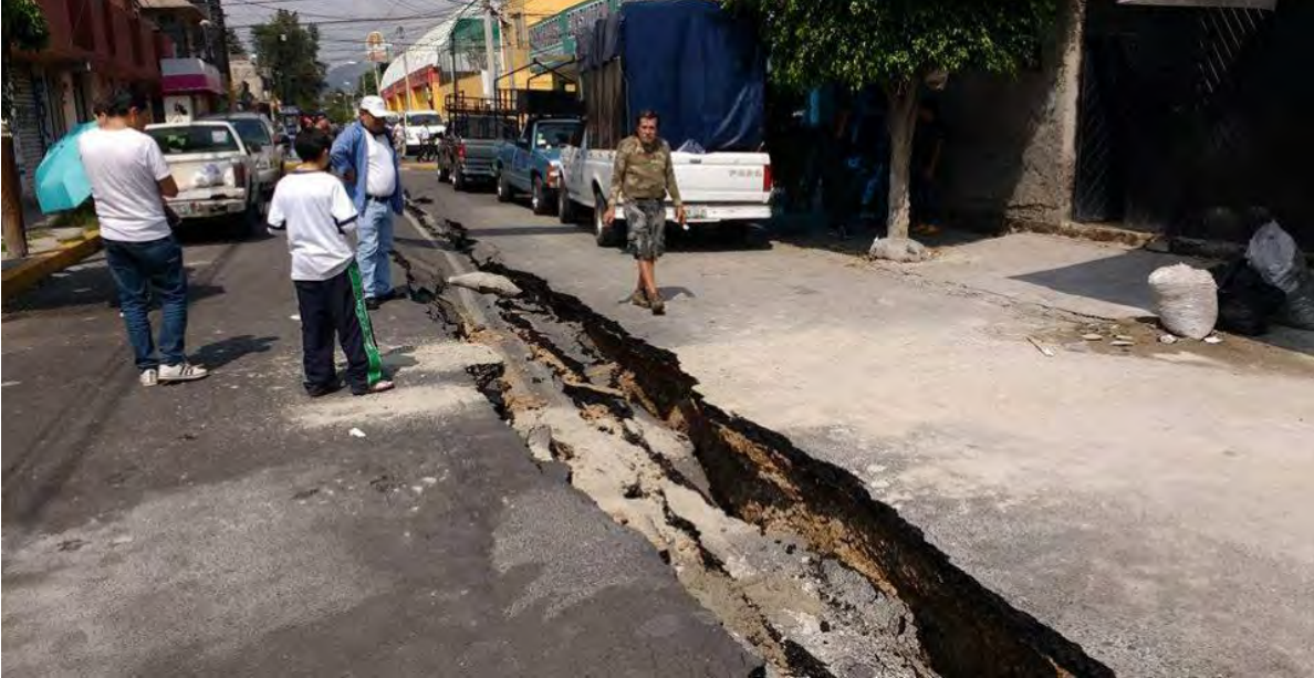
Figura 17. Grieta derivada del sismo del día 19 de septiembre de 2017 en la Colonia del Mar delegación Tláhuac.
