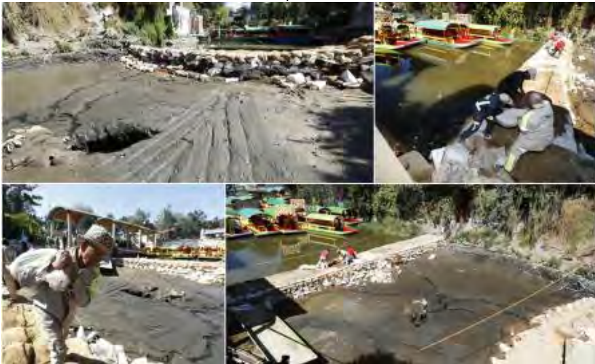
Figura 16. Fuga de agua ocasionada por una grieta en el embarcadero de Zacapa, Xochimilco, Ciudad de México. 2017.
