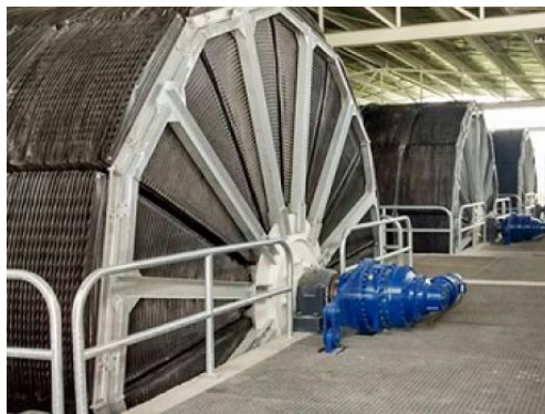
Figura 19. Planta de tratamiento de aguas residuales de Teuchitlán, Jalisco (Fuente: Operación y Mantenimiento de Aguas residuales. CEA Jalisco).
