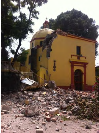
Imagen 2.4. Daños a la capilla de San Marcos, Xochimilco.
