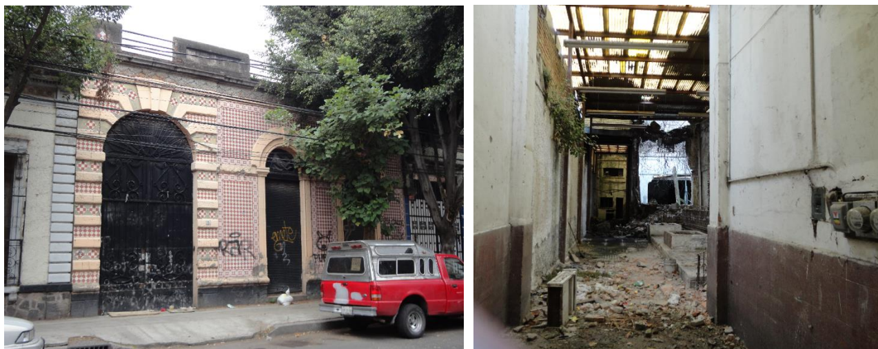
Fig. 93-94. Fachada principal sobre Eligio Ancona e interior de la antigua fábrica de velas. Fuente: fotos del autor, 2017.
