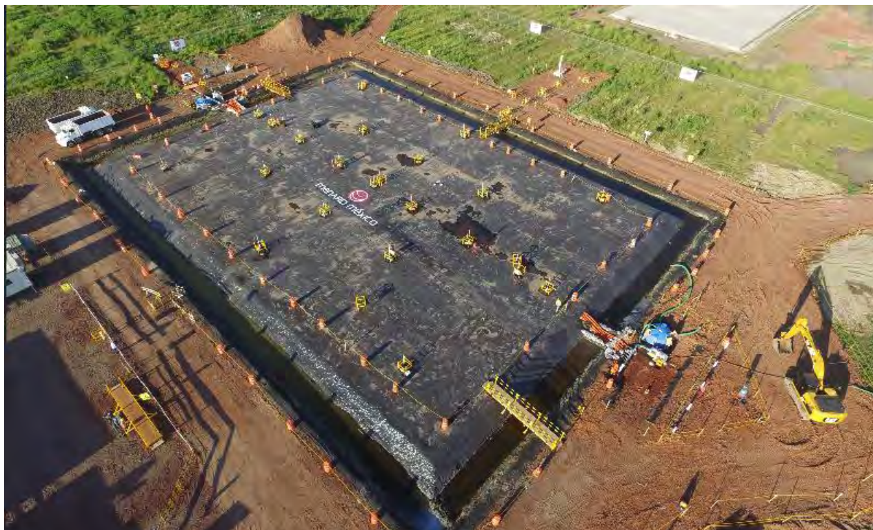
Figura 108.- “Foto aérea del panel de prueba del método de aceleración de la consolidación por vacío con membrana (Menard Vacuum)” Fuente: Menard México.
