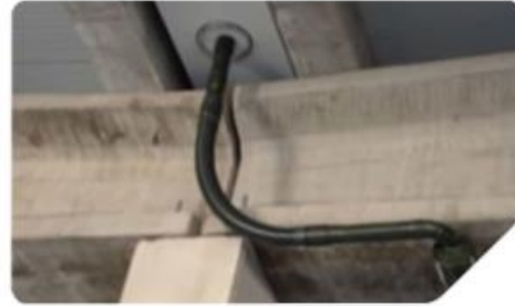
Captación desde canalón o cubierta
