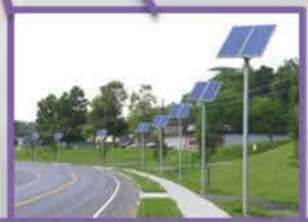
Luminarias de celdas fotovoltaicas
