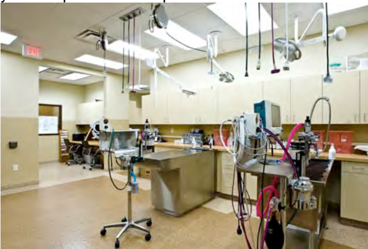
En esta foto se puede apreciar la sala de preparación para entrar al quirófano se puede observar el equipo y las instalaciones de gases en cada mesa de trabajo.
