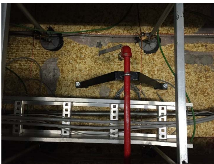
Figura 2.4 Cableado debajo de plafones
