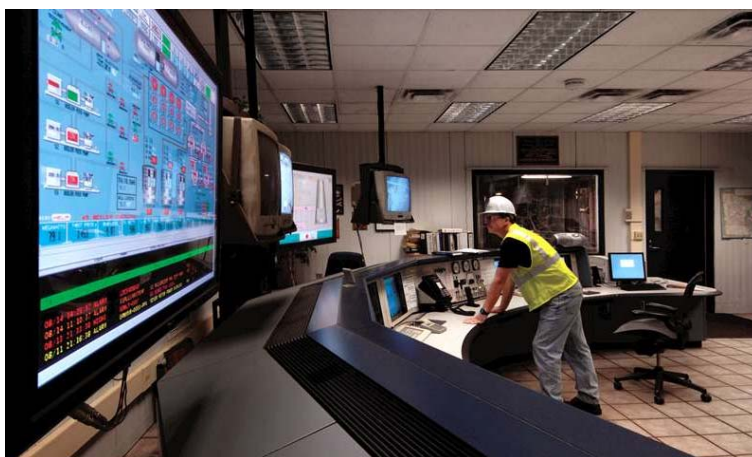
Figura 2.1 Cuarto de Control
