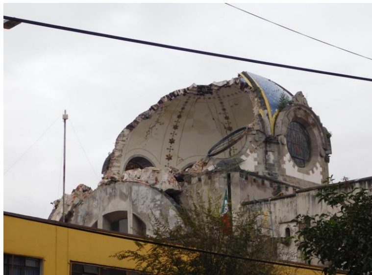
35. Restos de la cúpula de la iglesia de Nuestra Señora de los Ángeles. Colonia Guerrero, Ciudad de México. Imágenes tomadas el 28 de septiembre del 2017 de la cúpula caída. Fotografía: Dennise Salinas Vázquez.
