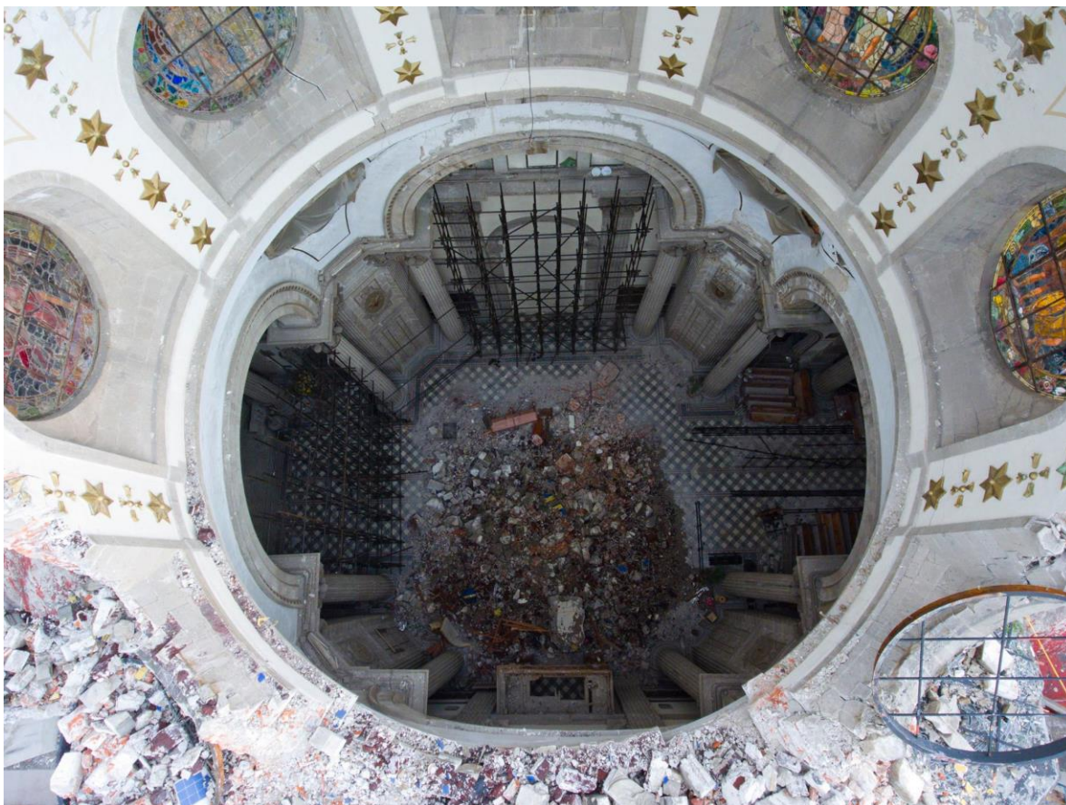
40. Acercamiento de la cúpula caída del templo de Nuestra Señora de los Ángeles. Colonia Guerrero, Ciudad de México. 15 de Octubre del 2017. Fotografía: José Carlos Mendoza Valdez.
