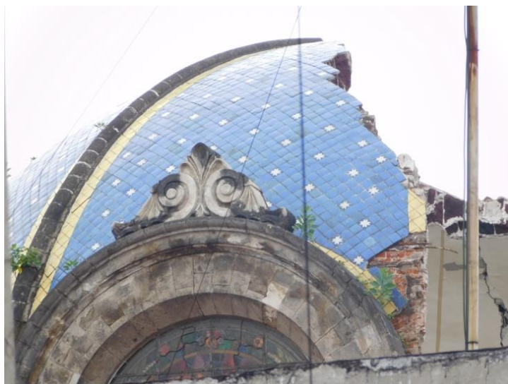
36. Acercamiento de la caída de cúpula. Colonia Guerrero, Ciudad de México. Imágenes tomadas el 28 de septiembre del 2017 de la cúpula caída. Fotografía: Dennise Salinas Vázquez.
