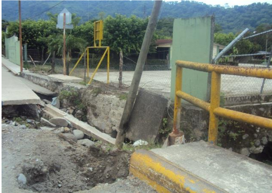
Figura 4.17. Daño en la barda de la Secundaria Técnica #52.
