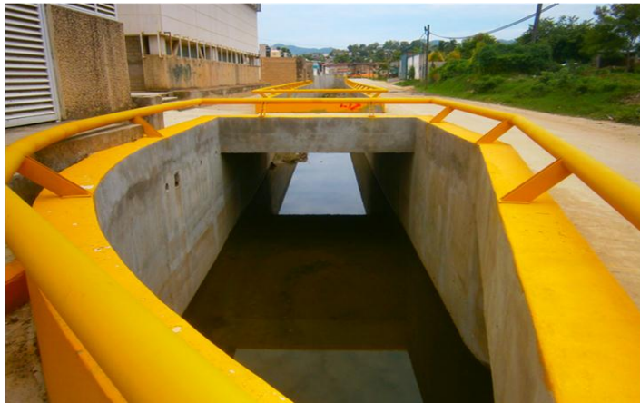
Anexo 4.17 Canal de desagüe construido en 2014 ante las recientes inundaciones de las tormentas e Ingrid y Manuel. Fuente fotografías tomadas por la autora en junio de 2015.
