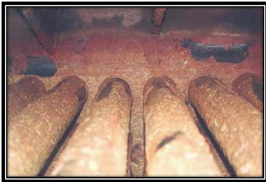
Figura 4.1 incrustaciones en calderas
