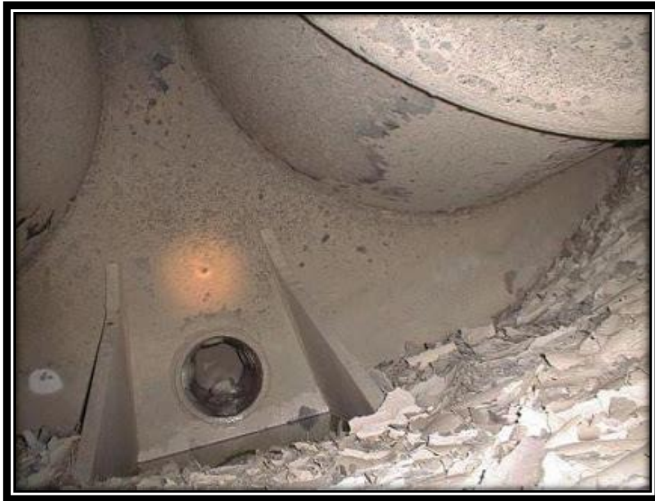
Figura 4. 2 Se puede apreciar incrustaciones en el fondo de la caldera
