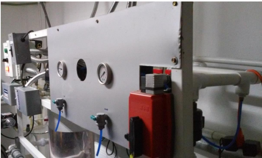
fig(6.11.6)equipo de ultrafiltración para la eliminación completa de virus y bacterias
