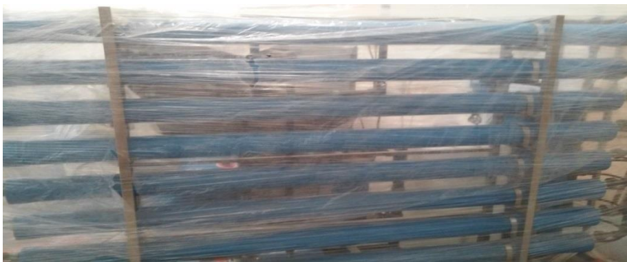
fig (6.11.1) tubería de paso de agua
