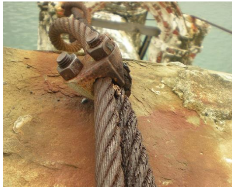
Figura 1.7. Ejemplo de corrosión por aireación diferencial [8].
