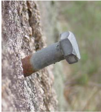
Figura 1.6. Ejemplo de corrosión por aireación diferencial [7].
