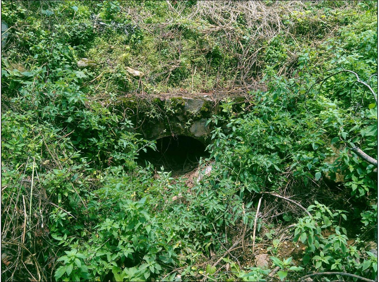
Fotografía 3.5.- Tubería actual del km 39+295.
