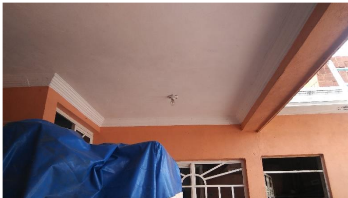
Imagen 3.7. Interior de la vivienda donde se observa algunas trabes.
