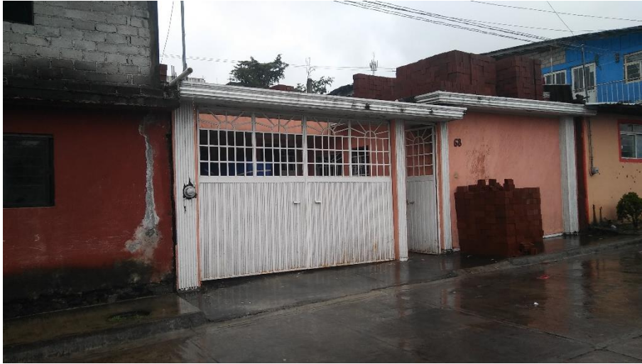
Imagen 3.5. Fachada principal donde se observa el descuido de la vivienda.
