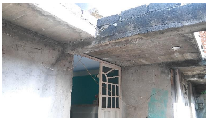
Imagen 3.8. Se observan algunas trabes y estado de la losa.
