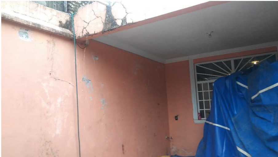
Imagen 3.6. Interior de la vivienda donde se observa algunas trabes con un claro considerable.
