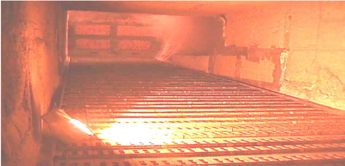
IMAGEN 4.11.2.1 ENFRIADOR DE CLINKER PRODUCIDO POR EL HORNO ROTATORIO NO. 4.
