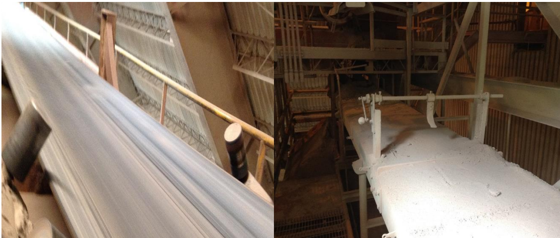
IMAGEN 7.3.5. DETECTORES DE MOVIMIENTO.
