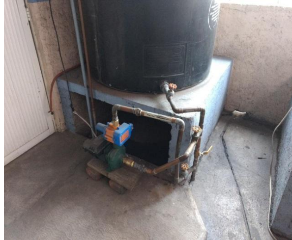
Figura 4.5. Bomba de agua sobre tabiques y madera.
