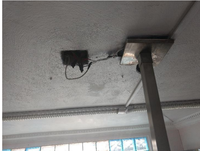
Figura 4.12. Instalaciones eléctricas sin mantenimiento
