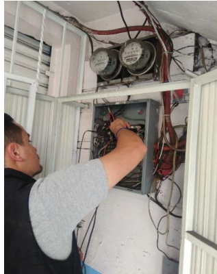
Figura 4.30. Revisión de cableado
