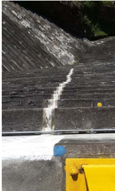
Figura 4- 27 Grieta vista hacia aguas abajo
