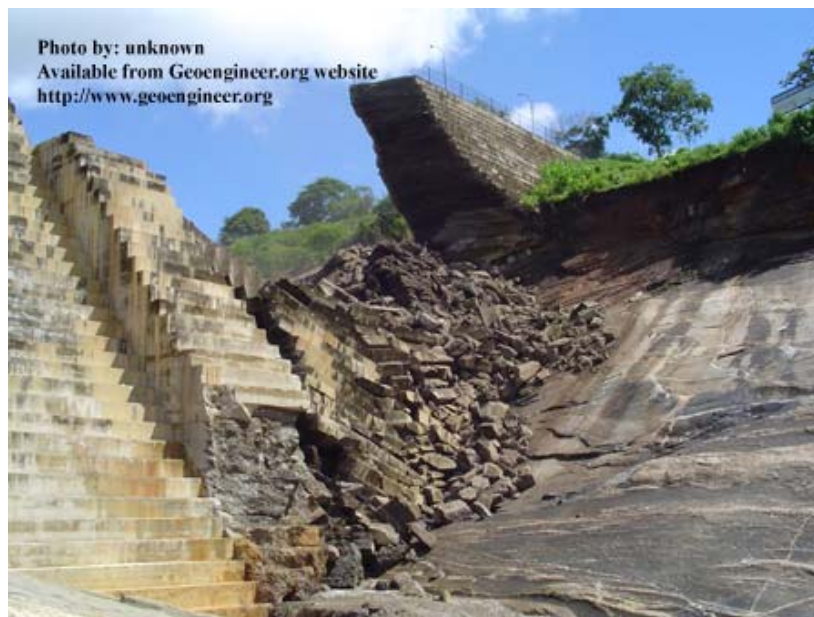
Figura 1- 17 Presa Camara de CCR (h=50 m) - Brasil 2004 - Falla de cimentación
