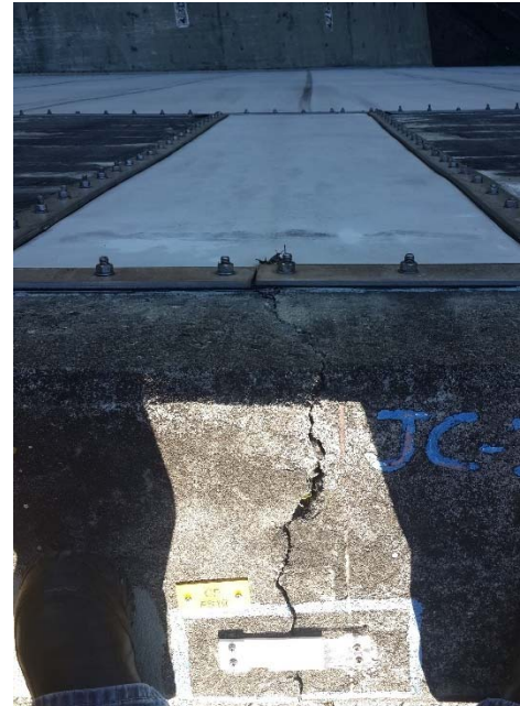
Figura 4- 28 Grieta vista aguas arriba
