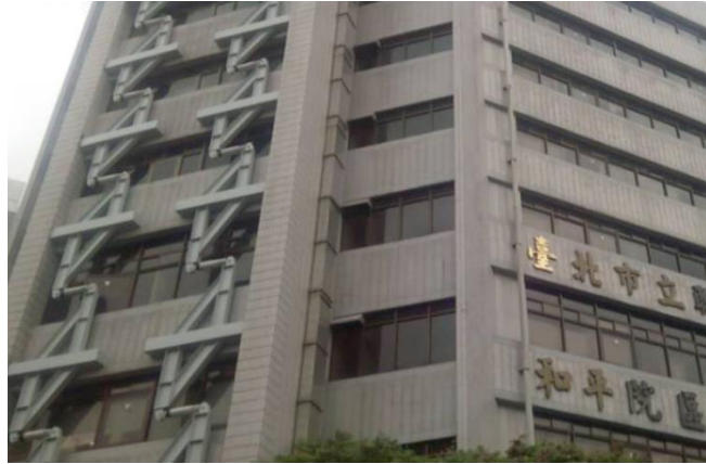
Fig. 1.3 Amortiguadores viscosos instalados en el Taipei City Hospital (Mageba México)
