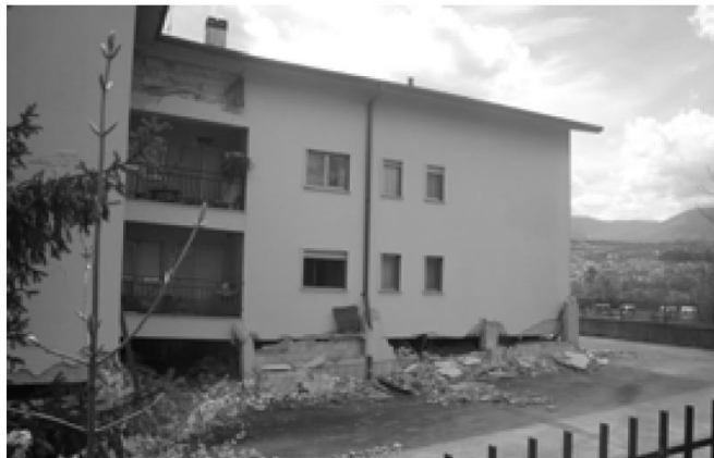
Fig. 1.2 Colapso de edificio por piso suave en el sismo de L'Aquila (Italia 2009)
