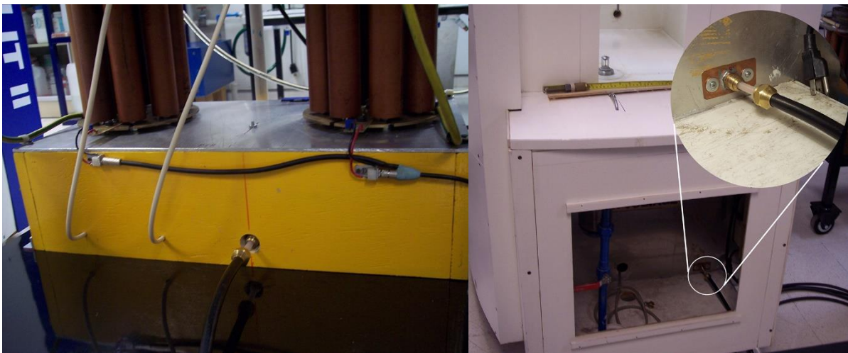
Fig. 2.31 Conectores del alto voltaje tanto en el GET (izq.) como en el MEXILIT (der.).
