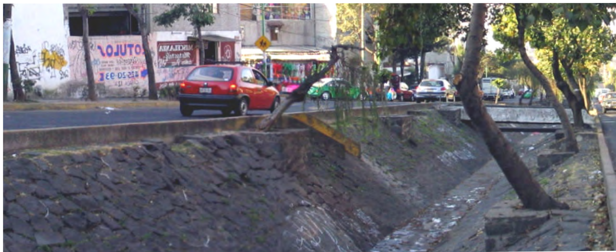
(Foto 1). Fotos de la Zona de estudio, Cerro del Judío, Delegación Magdalena Contreras. contaminación de pasos de agua pluvial a cielo abierto.
