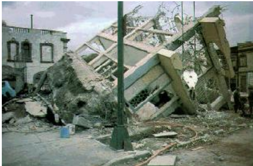
Figura 1.2. Volcamiento de un edificio con respecto a un punto situado a la mitad de la base, causado por el sismo del 19 de septiembre de 1985 (Cortesía: M. J. Mendoza, Instituto de Ingeniería, UNAM).
