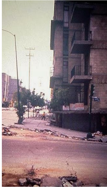
Figura 1.1. Asentamiento excesivo en un edificio en la Ciudad de México ocurrido durante el sismo del 19 septiembre de 1985 (Cortesía: M. J. Mendoza, Instituto de Ingeniería, UNAM).
