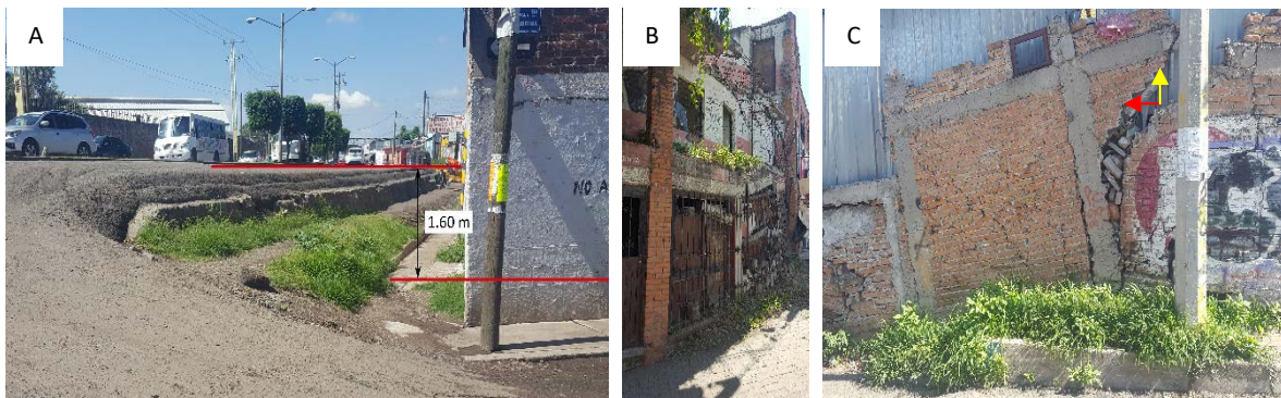
Figura 50. Fenómeno de subsidencia en el área de estudio, Centro Sur de la Ciudad de Irapuato. A) Hundimiento diferencial de aproximadamente 1.60 metros. B) Intensidad del daño a las edificaciones en el área de influencia de las fallas. C) En la imagen puede apreciarse la magnitud de las componentes de desplazamiento lateral y vertical debidas al proceso de subsidencia.
