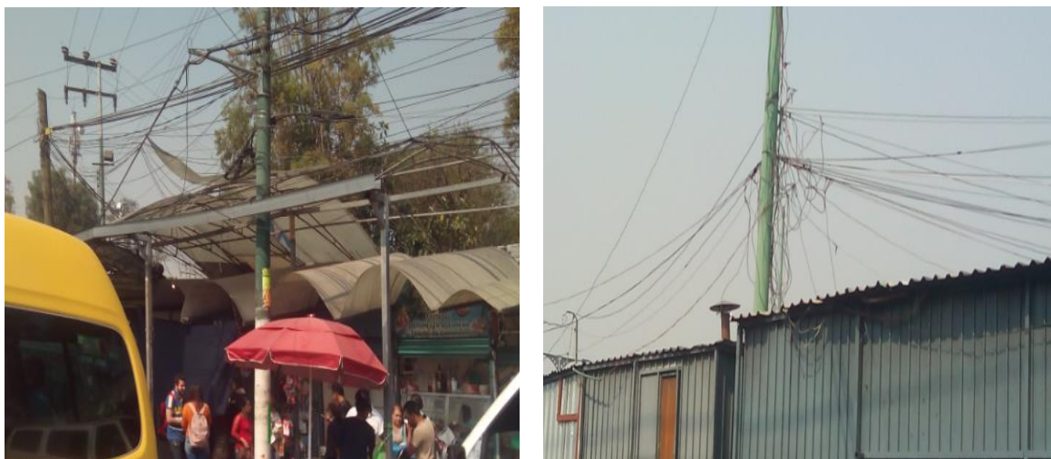
Figura 2.12 Conexiones eléctricas de los puestos informales
