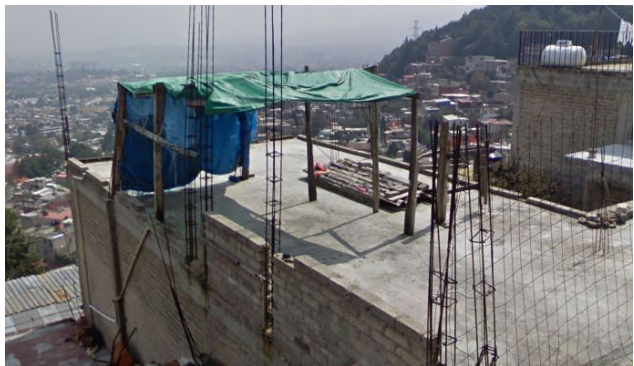
215. Cubiertas sin impermeabilización o recubrimiento
