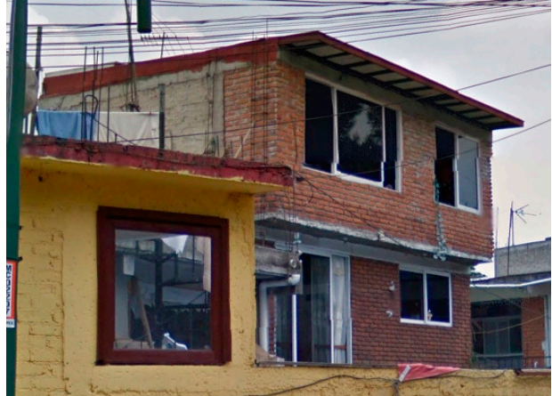
218. Vivienda con cubierta improvisada de lámina
