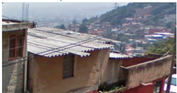
207. Láminas de asbesto
