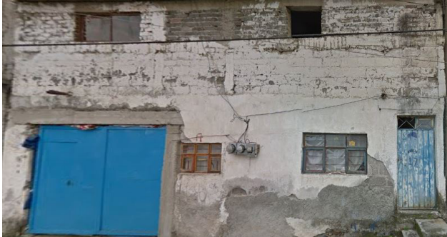
114. Estado actual de los muros de una vivienda habitada
