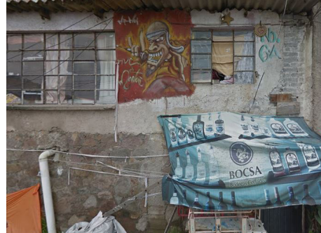
115. Pasos de instalaciones improvisados
