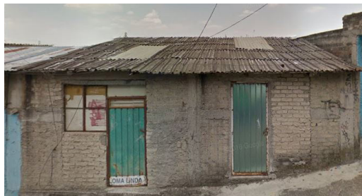
213. Mal estado de los materiales
