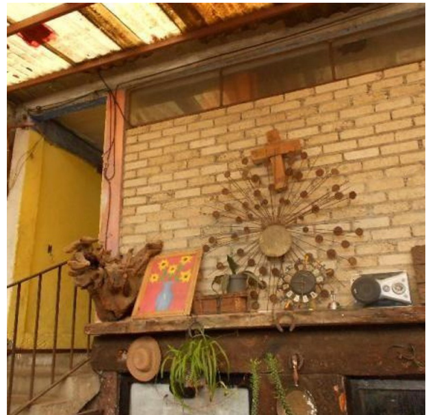
118. Estado de los muros al interior de una vivienda
