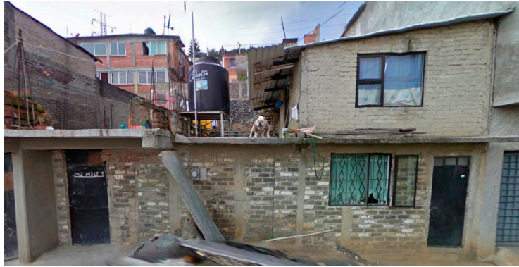
233. La ventana inferior no requiere de un cerramiento adicional mientras que la superior sí.
