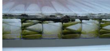
282. Humedad en placas de policarbonato
