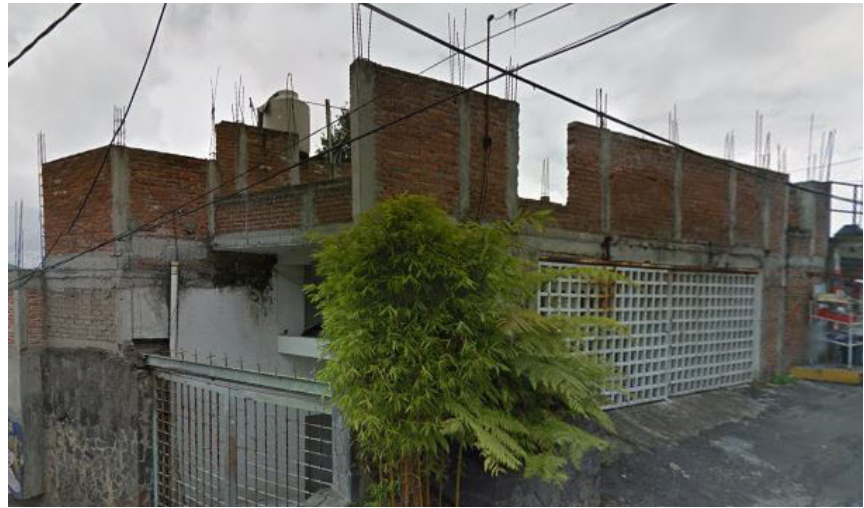
321. El acero de refuerzo permanece expuesto a la intemperie
