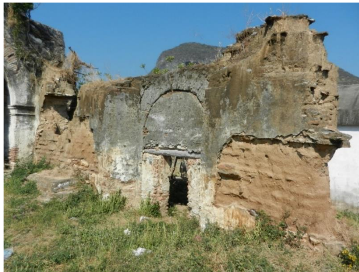
Figura 99. Sistema constructivo de muros de adobe con refuerzos de tabique en el perfilado de vanos y esquinas. Se aprecian los aplanados de mortero de cal y arena. La imagen es de 2016 y muestra una porción del muro norte del templo de La Magdalena Tlacotepec hoy en ruinas. Foto del autor.
