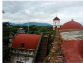
2. El templo está cubierto por bóvedas de cañón en el presbiterio y coro; de cañón en la nave y una capilla anexa.
