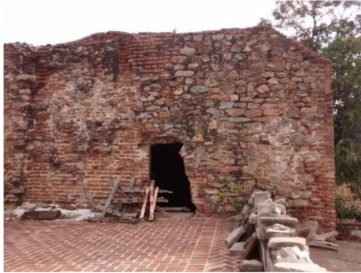
Figura 100. Sistema constructivo con mampostería mixta de piedra de cerro (granodiorita y calizas), piedra bola de río y tabique unidos con mortero de cal y arena de río. La imagen es de 2016 y muestra los comunes (sanitarios) del convento de Santo Domingo Tehuantepec, Oaxaca. Esta obra se inició en 1544. Foto del autor.
