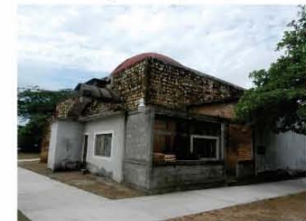
6. Al ábside se le añadió una sacristía a finales de la década de 1960. Estas obras recientes causan numerosos daños al inmueble.
