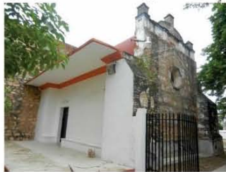
5. Capilla de los Santos Juanes. Se terminó en 1820. Su cubierta de tejado se sustituyó por una bóveda de cañón a finales del siglo XIX. Se aprecia el hastial en el muro testero.
