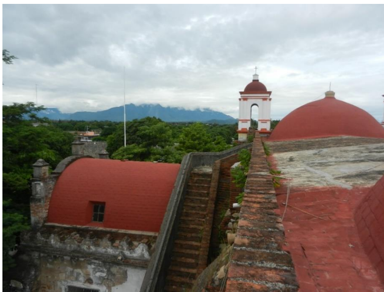
Figura 104. Entre 1550 y 1555 algunas comunidades Zapotecas del Istmo Sur sustituyeron las cubiertas de tejado de sus templos por bóvedas vaídas, gallonadas y de cañón corrido construidas con tabique y mortero de cal. Templo de San Jerónimo Doctor, Ixtepec, en 2015. Foto del autor.
