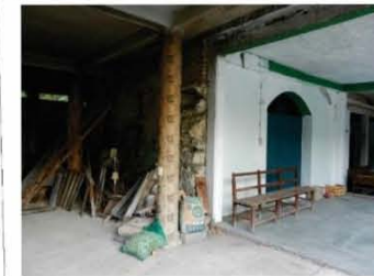
5. La capilla mayor de Laoyaga quedó aislada al construirse el templo. Hoy se utiliza como bodega y las intervenciones recientes han provocado su ruina.
