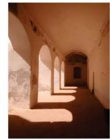
4. Los corredores del primer nivel se abren en vanos de medio punto hacia el patio central. Aun conservan pintura mural, deteriorada y con riesgo de desaparecer.
