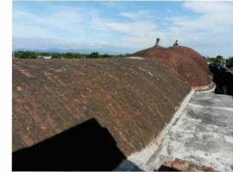
3. En primer plano la bóveda de cañón que cubre el coro. Al fondo las bóvedas vaídas de la nave y presbiterio. Es el único templo concebido con cubiertas vaídas en su totalidad.
