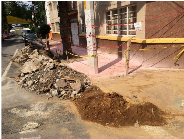
Figura 2. Residuos de Construcción almacenados incorrectamente
