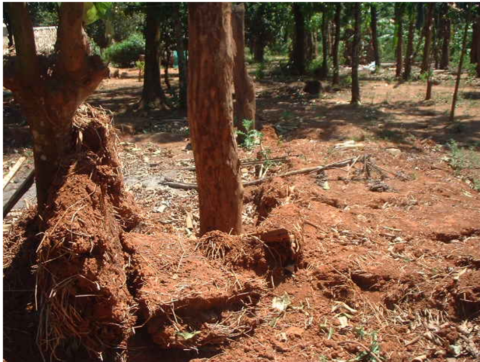
Figura 4.34. Detalle de las paredes caídas hacia afuera de la estructura y los horcones, después del huracán. El techo, que cayó sobre el piso ya había sido desmantelado y llevado a otra parte del terreno.
