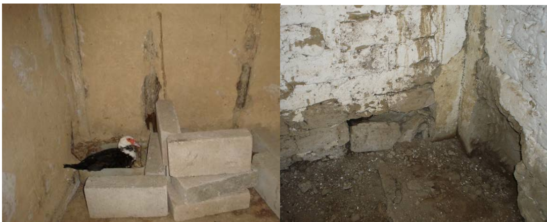
Figura 4.36. Ejemplos de desgaste del piso y la pared de tierra en las esquinas de la casa.
