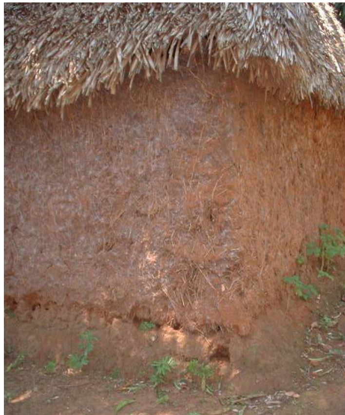
Figura 4.19. Techo sin botaguano, observar cómo afecta la superficie y la base de la pared.
