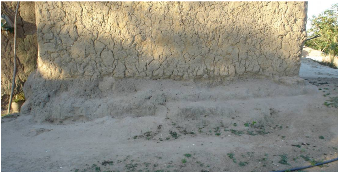
Figura 4.42. Detalle del escalonamiento que se forma por el deslave de los muros.
