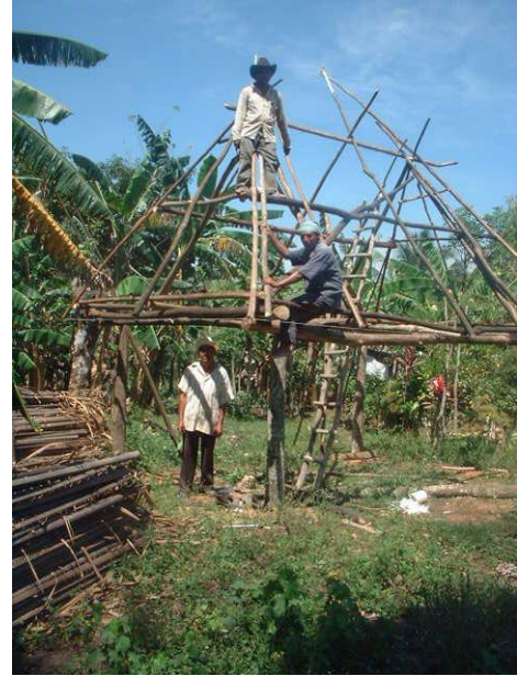
Figura 4.13. Izquierda, colocación de las Tijeras. Tomado de Wauchope 1938: figura 43c. Derecha, construcción de la estructura del techo en el poblado de Úrsulo Galván.
