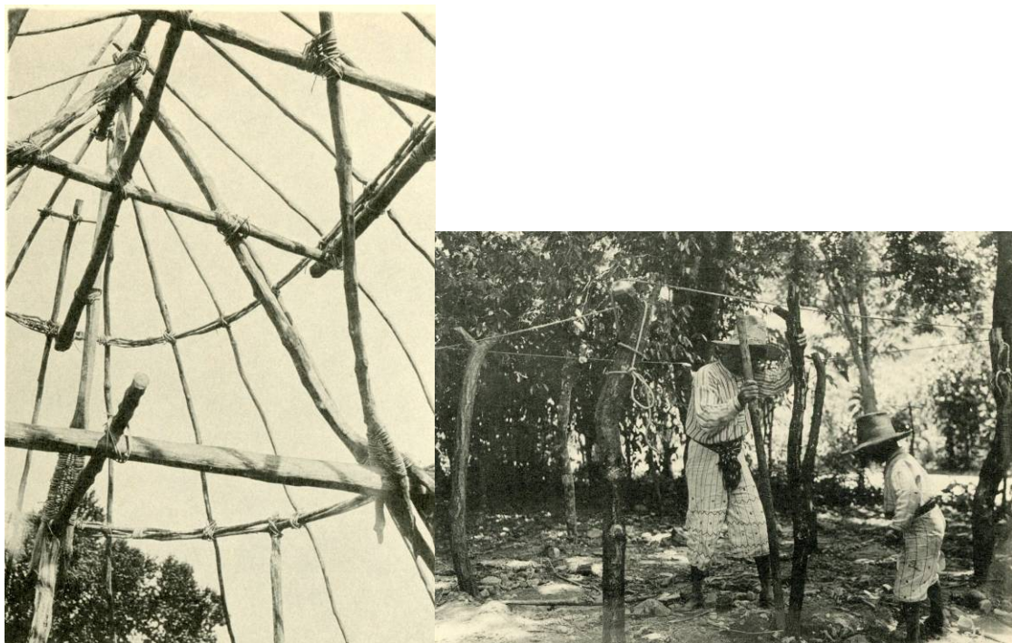
Figura 2.11. Izquierda, estructura del techo que se coloca sobre los horcones. Derecha, implantando los horcones. Tomadas de Wauchope 1938: láminas 8d y 10a.
