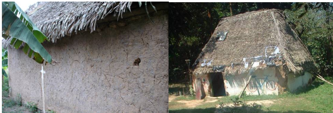
Figura 4.32. Izquierda, vista de la afectación por insectos en una pared. Derecha, vista de los reforzamientos en una pared. Ambas paredes son de barro.
