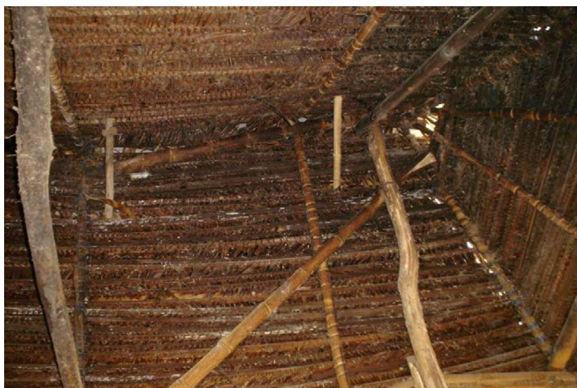
Figura 4.17. Vista interna de la estructura del techo. Al centro en diagonal se observa el contraviento.
