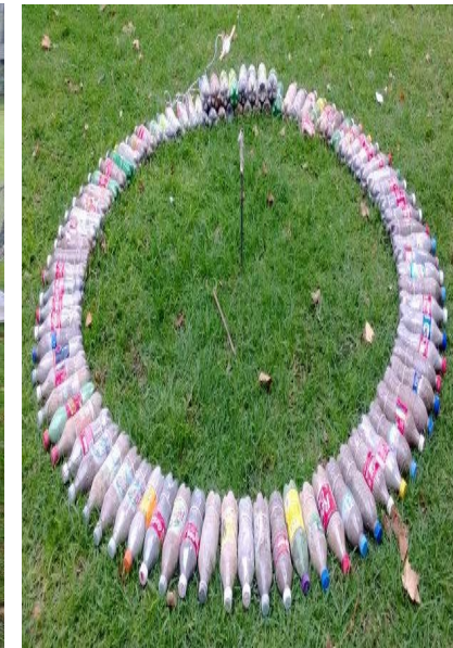
Imagen 14.0 Desplante circular de botellas para la construcción de tanque de recolección de agua.
