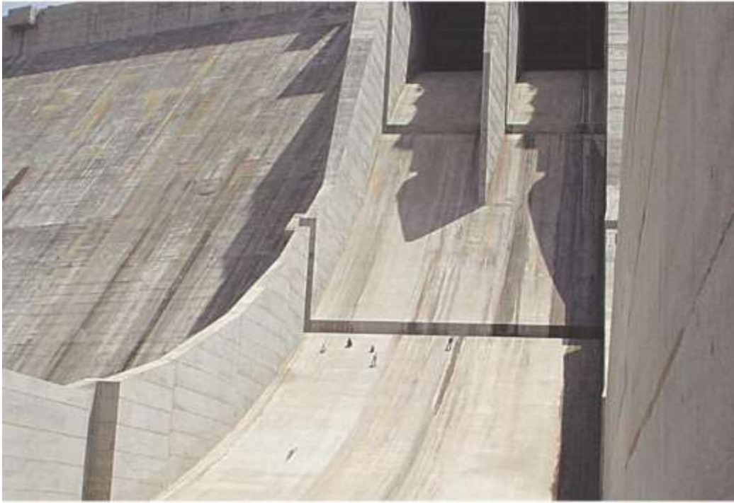
Figura 2.28. Aireadores de la presa de Huites, México (CONAGUA, 1999).
