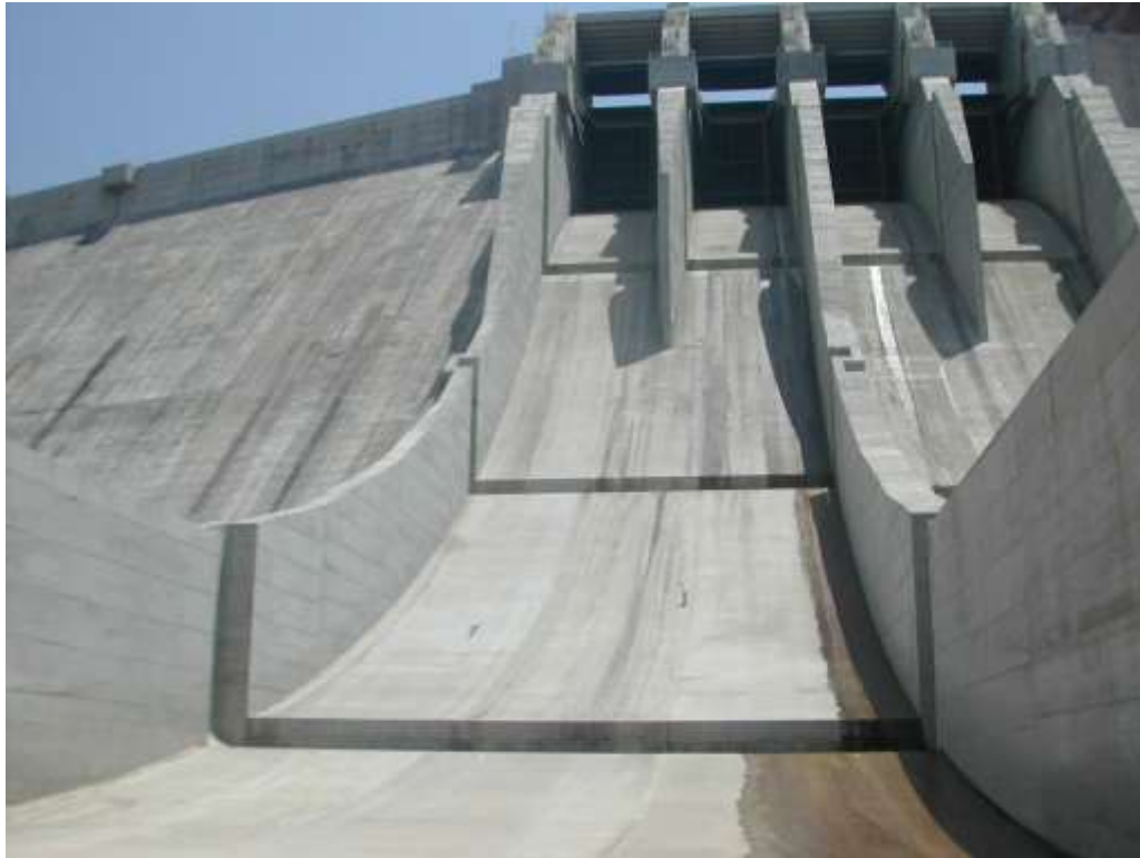
Figura 3.10. Vista frontal de los canales de descarga y aireadores del vertedor de la presa Huites.
