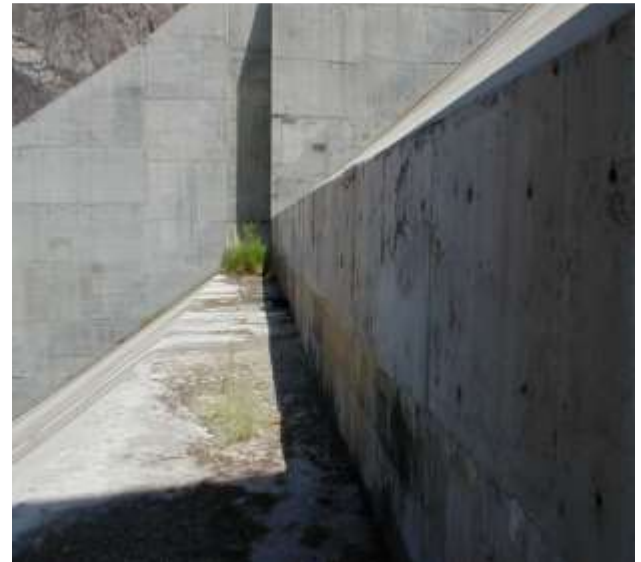
Figura 3.12. Vista del aireador (margen derecha).
