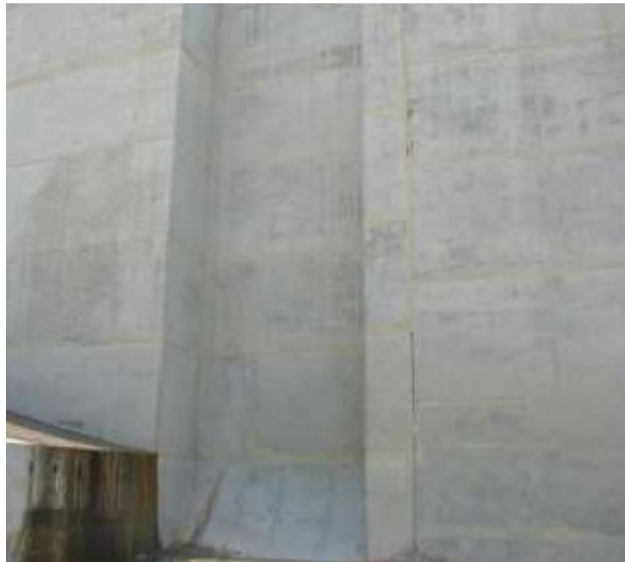
Figura 3.11 Vista del aireador (margen izquierda).
