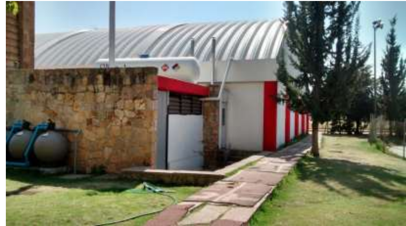
Vista de la bodega de la alberca, y el cuarto de máquinas que se encuentra a un costado.
