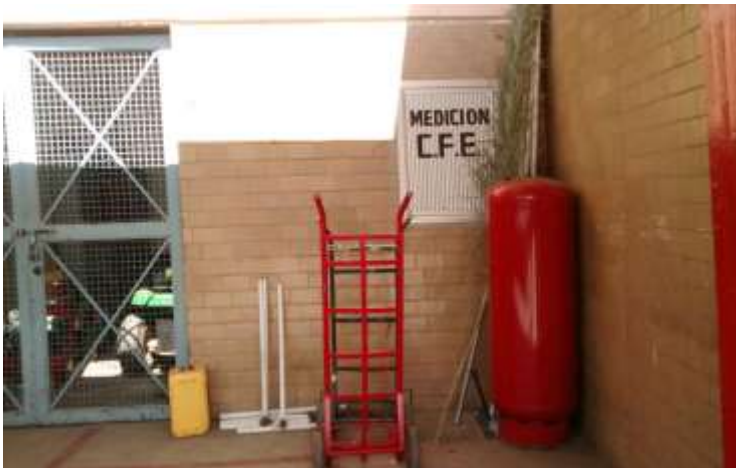
Vista de acceso a área de máquinas y medidor de CFE
