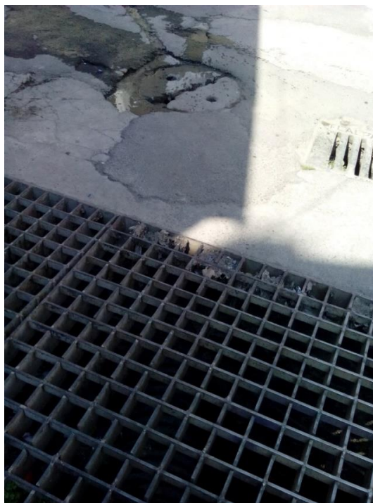
Figura 2. 12 Mismo pozo de captación, se sigue la dirección del tubo negro y se observa que conecta con el drenaje de la calle Pirindos Fuente. Obtención Propia
