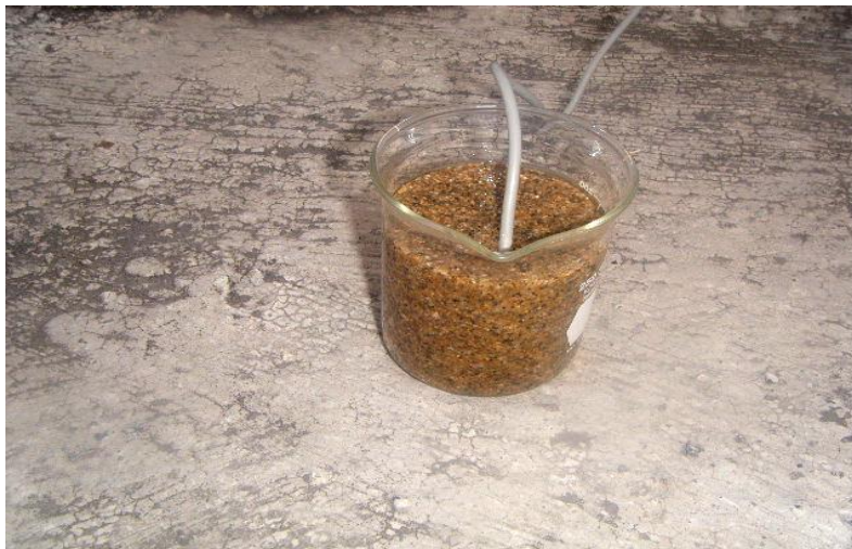
Figura A2. Muestra de arena sobre el techo del edificio del estudio de caso.
