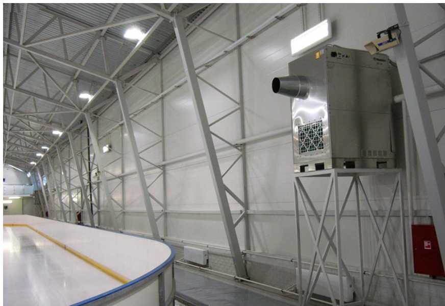
Sistema de deshumidificación de la pista de hielo
