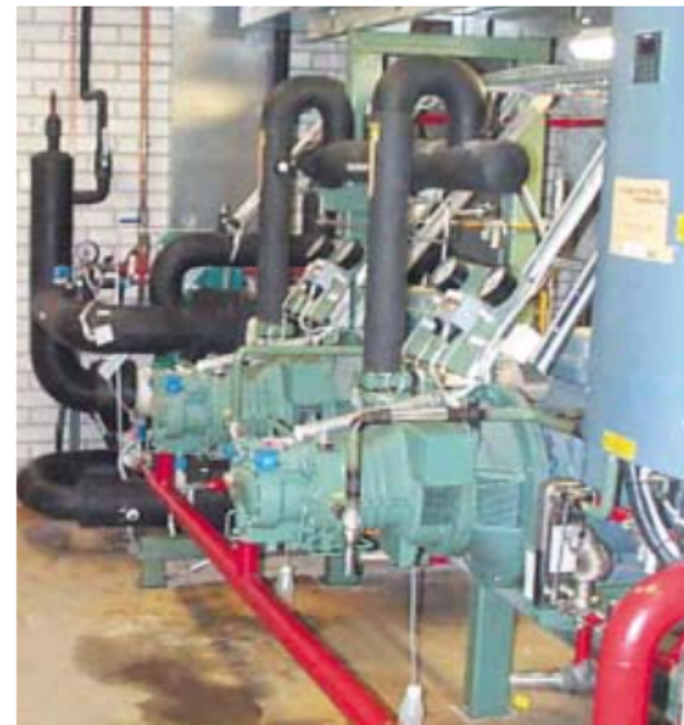
Dos compresores de tornillo FUENTE: http://www.iihf.com/fileadmin/user_upload/PDF/Rink_Guide/IIHF_Ice_Rink_Guide_web_pdf.pdf
