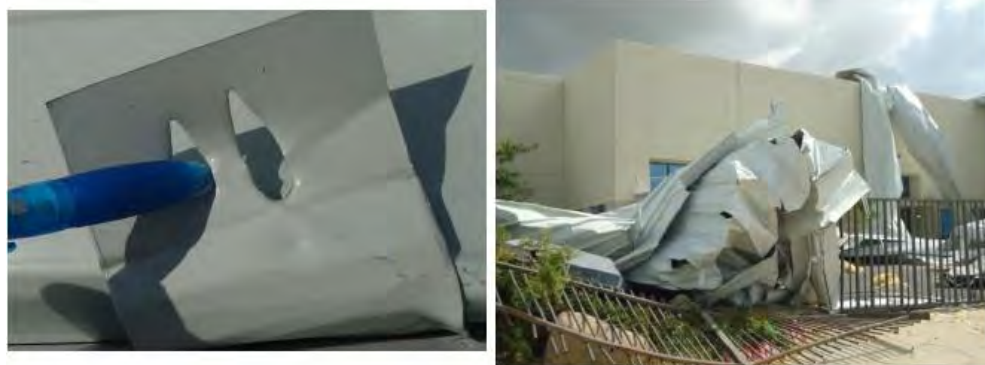
Figura 2.2. Falla local en los sujetadores de la lámina. (Murià, et al., 2016)
