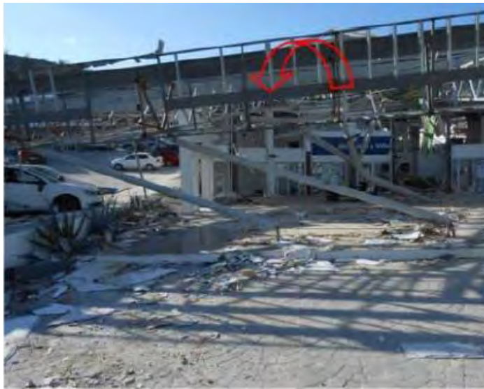
Figura 1.1. Colapso de Nave Comercial por el huracán Odile en Baja California (Murià, et al., 2016).
