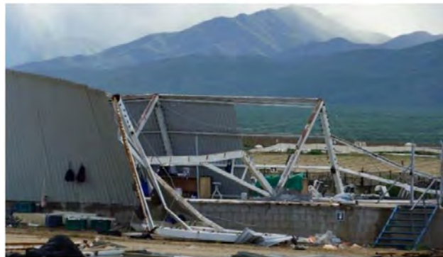
Figura 2.1. Colapso parcial de nave industrial a causa del Huracán Odile. (Murià, et al., 2016)
