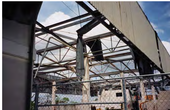
Figura 2.14. Colapso de techumbre en bodega de almacenamiento (López Bátiz & Toledo Sánchez, 2003).
