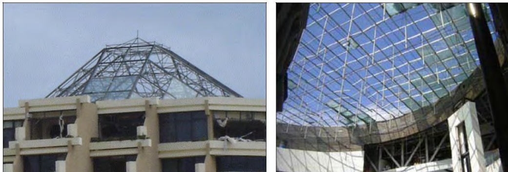
Figura 2.3. Daños a domos y tragaluces (Avelar, 2006).
