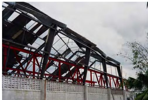
Figura 2.15. Falla en el anclaje a causa de la corrosión en los tornillos (López Bátiz & Toledo Sánchez, 2003)
