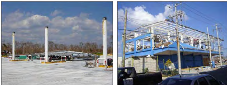
Figura 2.4. Daños a cubiertas en gasolinera y bodega (Avelar, 2006).
