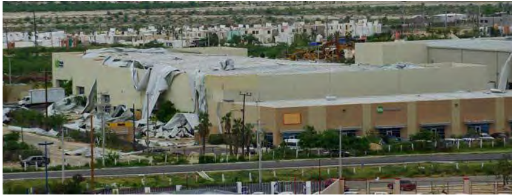
Figura 2.6. Daños en cubiertas de nave comercial. (Murià, et al., 2016)
