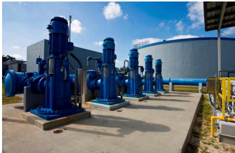
Figura 7 Planta de bombeo de agua 10
