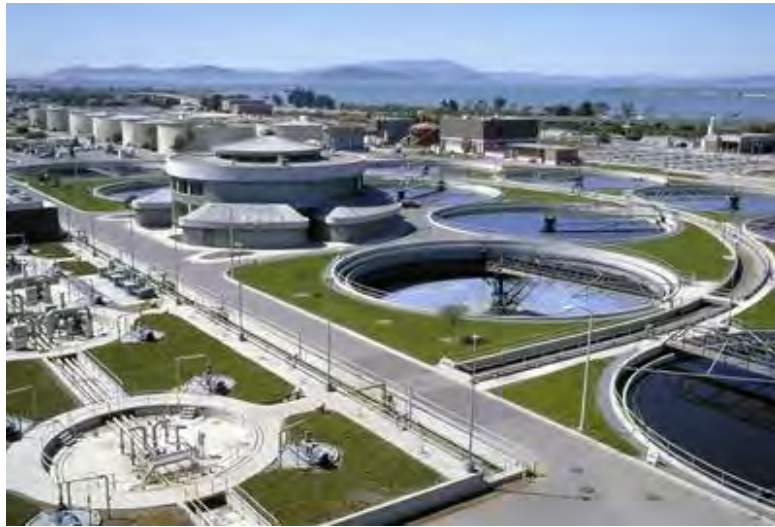
Figura 8 Planta de tratamiento de aguas residuales 11
