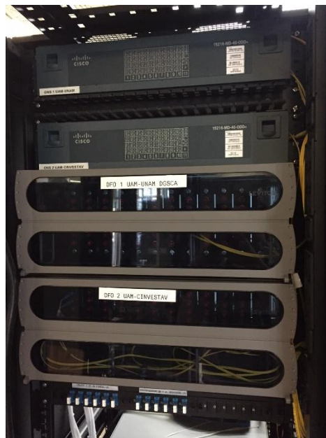
Figura 1.1. Paneles de Distribución de Fibra Óptica.
