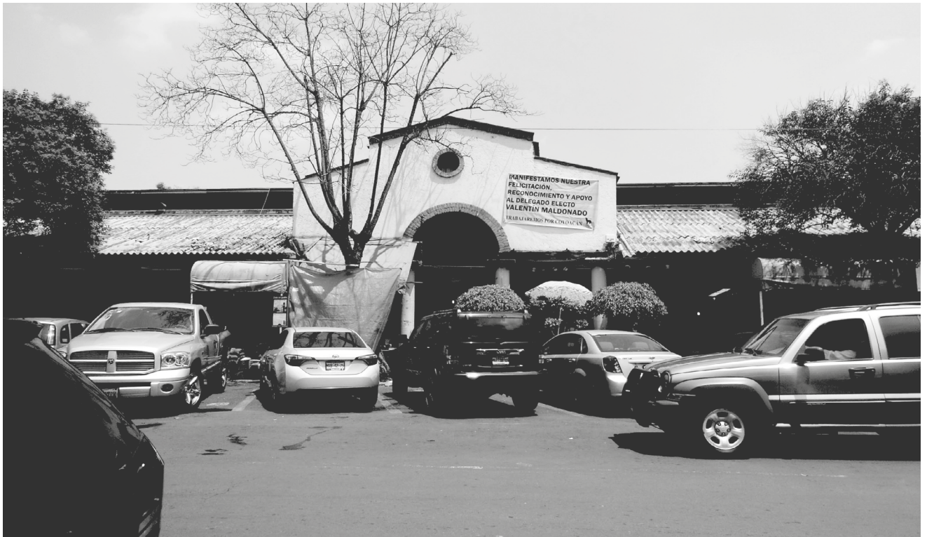
Imagen 34. Entrada principal del mercado. Fachada intervenida por arcos y columnas rompiendo con la estética original.
