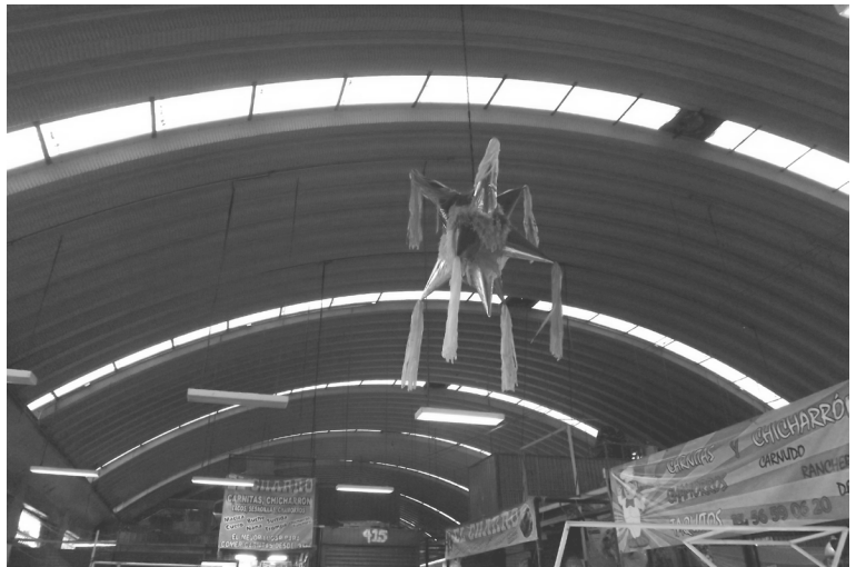
Imagen 38. Bloqueo de iluminación en mercado: cubierta de lámina en área de tianguis.
