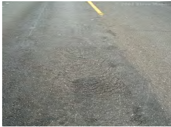
Fig. 2-7 Grietas de deslizamiento (Interactive, 2009)
