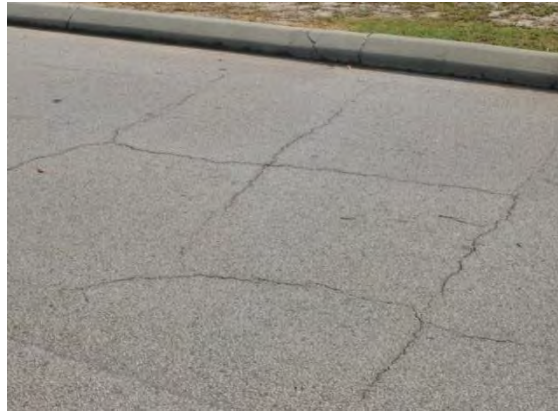
Fig. 2-5 Grietas en bloque (Interactive, 2009)
