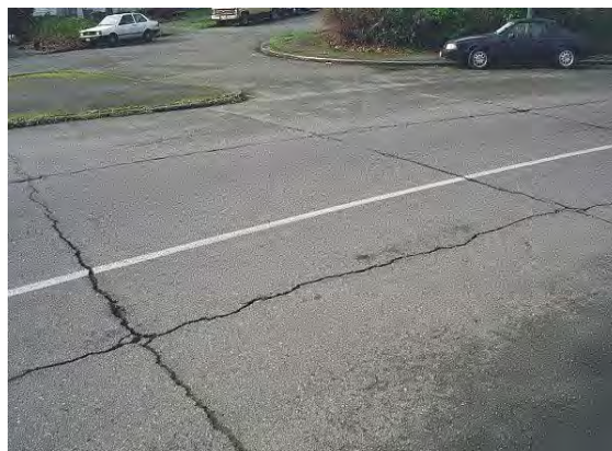
Fig. 2-6 Grietas reflejadas (Interactive, 2009)
