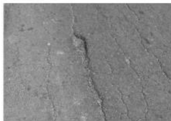
Fig. 2-4 Agrietamiento longitudinal (Adlinge & Gupta, 2013)
