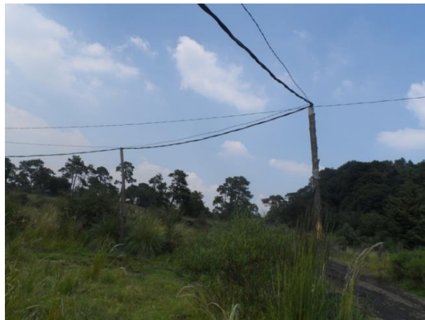
Figura 4.16. Servicio de electricidad en asentamientos humanos irregulares.
