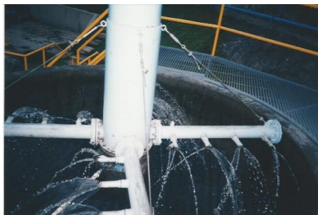
Filtro rociador Foto 29 B
