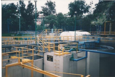
Planta de tratamiento de Ciudad Universitaria Foto 29 A
