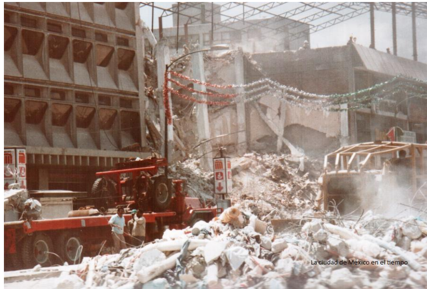
Figura 1.3 Daños en estaciones del metro después del sismo, estación Isabel la Católica
