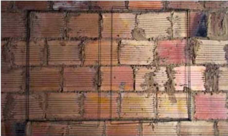
54. Detalle de la estructura de hilo en primer nivel de la caseta
