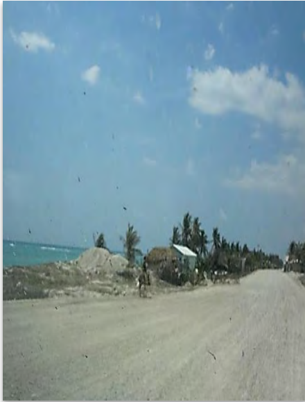
Ilustración 4 Estado actual de la carretera departamental RD23 en el tramo de Aquin hacia Côtés de Fer.
