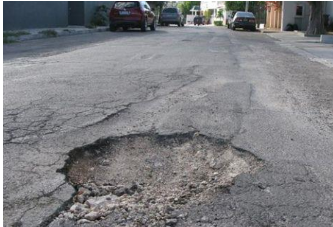
Figura 7. Desprendimiento de agregados.
