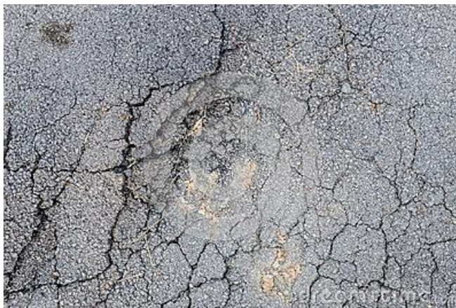
Figura 5. Agrietamiento en capa de rodadura.
