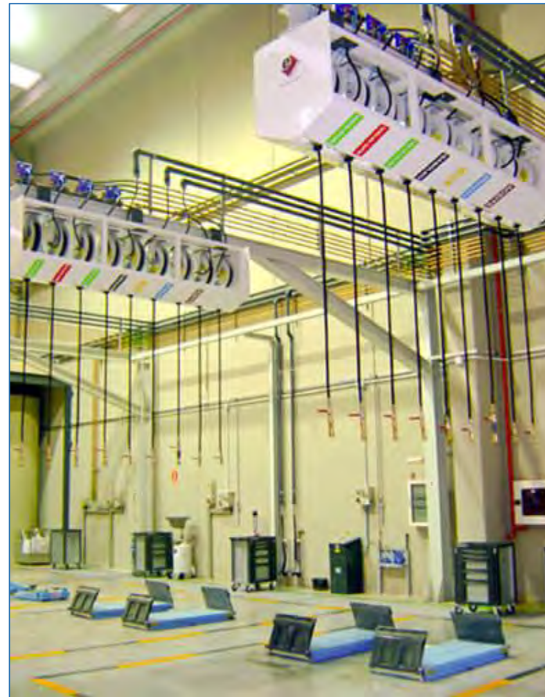
Figura 6.14 Zona de extracción de líquidos
